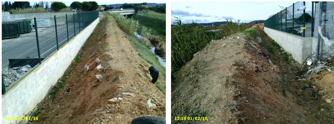
Figure 35: anomalie du profil en long de la digue
