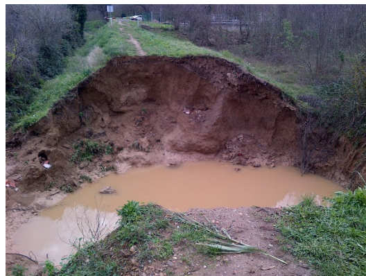
Brèche dans la digue
