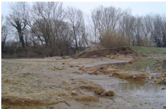
Brèche dans la digue de l'Aude après la crue de novembre 2005
