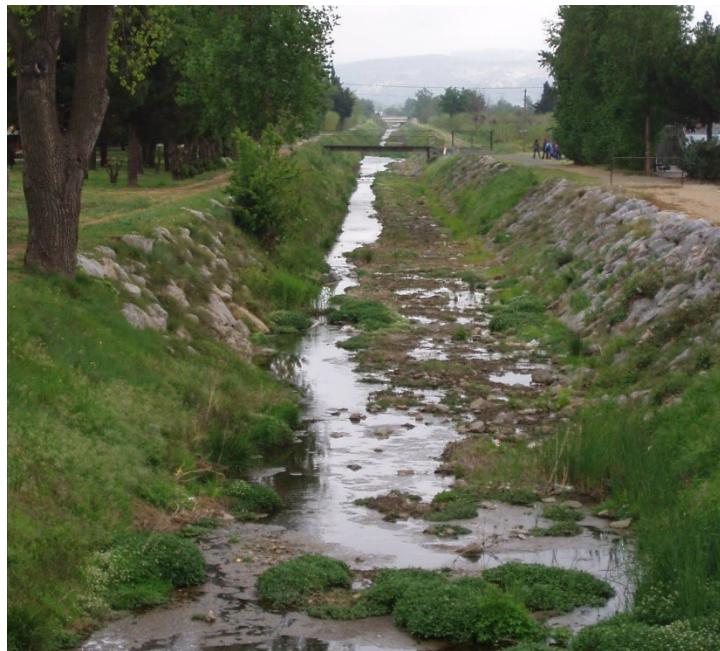
Figure 44 : Lit mineur du Rec de Veyret - vue vers l'aval du pont de la RN2009 (Source BG)
