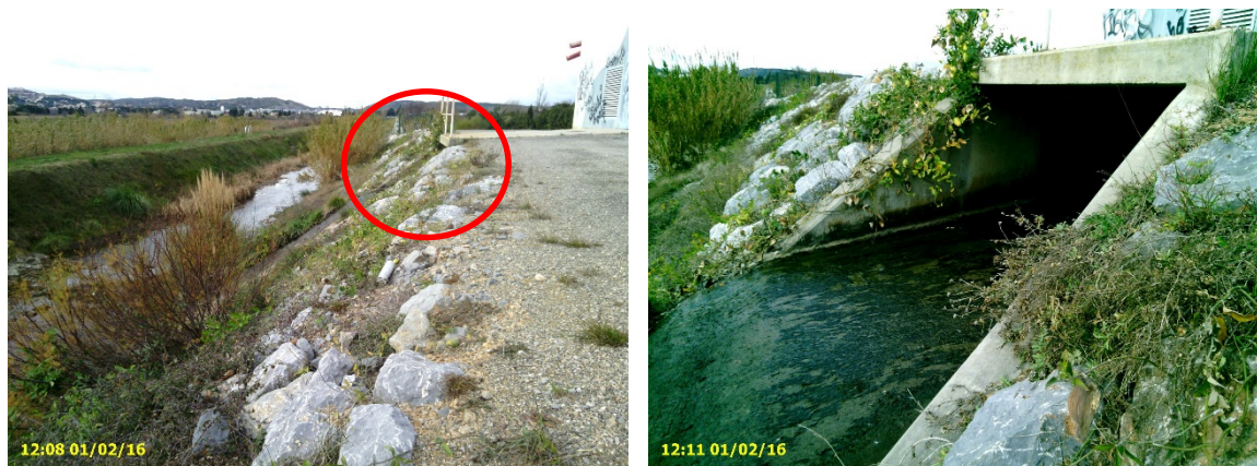
Figure 40: OH du bassin de rétention
