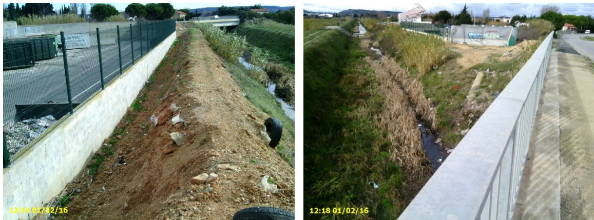
Figure 22: Tronçon non circulaire en amont du pont de la route de Lunes
