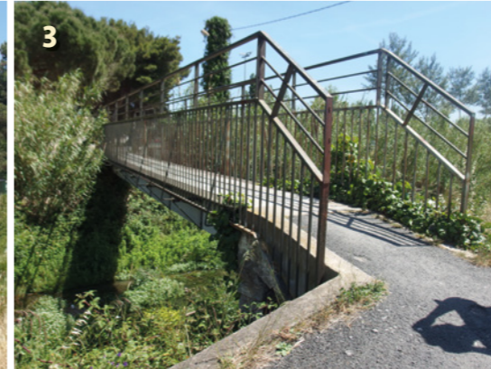
3. Passerelle piétonne en mauvaise état, à remplacer par un ouvrage de 3m de large (vélo/piétons), avec rampe PMR à prévoir (1,50m), longueur 25m au maximum sans appui intermédiaire; béton (ou bois).
