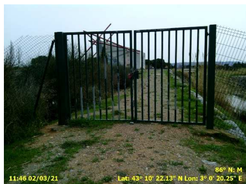
Point 464 : clôture et portail d'entrée de la station au niveau de la crête de digue
