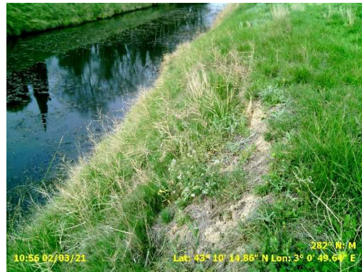
Point 488 : glissement vu vers l'amont
