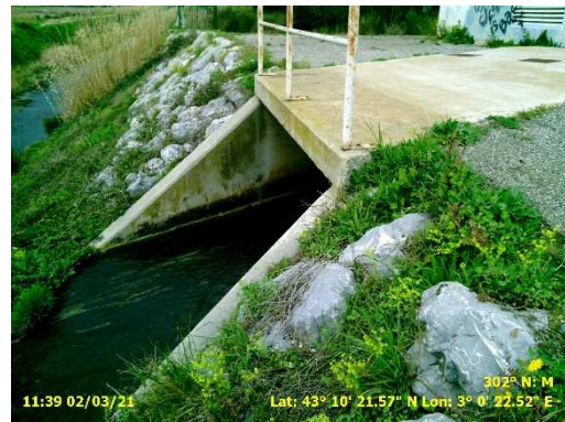
Vue du refoulement de la station sur le haut du talus côté rivière
