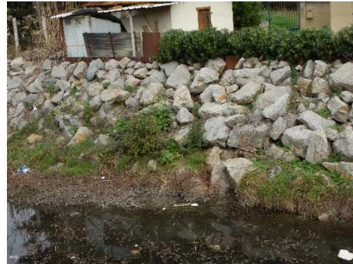
Linéaire 139 Palplanches métalliques au niveau de la maison encastrée sur 30 m de long avec quelques blocs déstabilisés en pied
