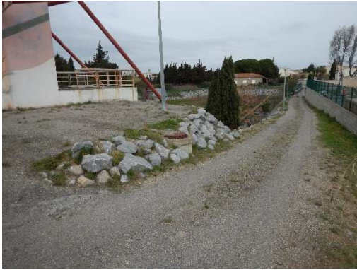
Station de pompage vue depuis la crête vers le côté terre
