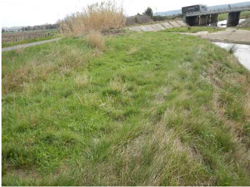
Point 488 : Glissement sur 1 m de haut et 3 m de large sur haut du talus côté cours d'eau
