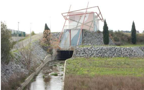
Vue de la station depuis le bassin tampon côté zone protégée
