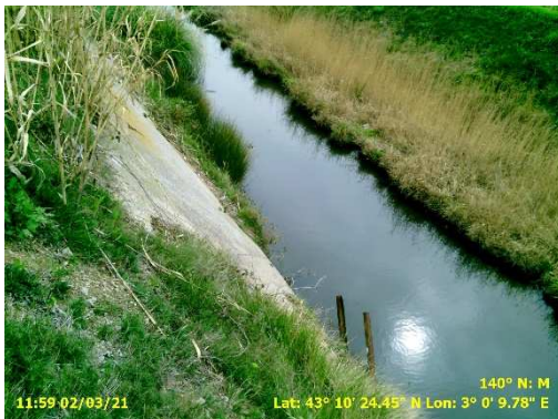
Talus bétonné au niveau du point carto 455 (présence d'un ouvrage hydraulique dans le fond du lit ?)
