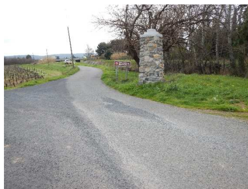
Vue de la digue vers l'aval au niveau du chemin de Saint-Charles
