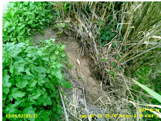
Piétinement sur le haut du talus de la digue côté terre
