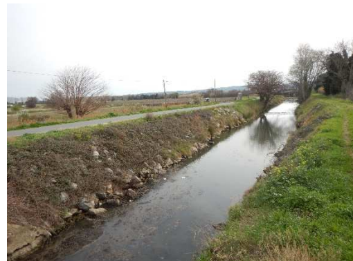
Linéaire 141 : encochements libres sur le talus côté amont au niveau du pont du chemin de la Cafforte (70 m de long)
