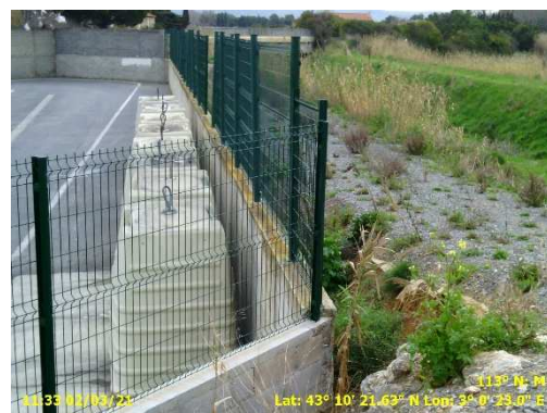
Linéaire 138 : clôture avec muret en pied de talus au droit de la déchèterie situé en aval de la station
