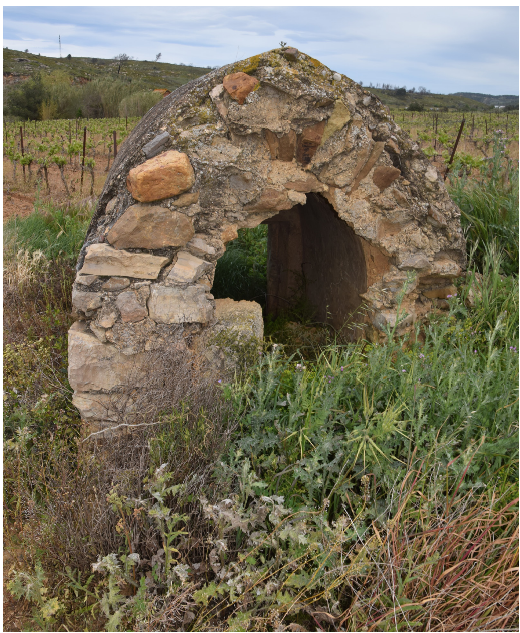
Destruction partielle de la montjoie n°125
