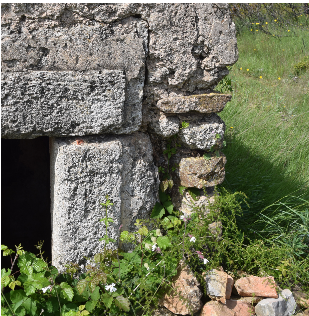
Déjointoiement des pierres sur la montjoie n°84
