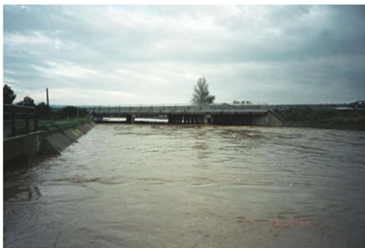
au déversoir de La Cafforte, daté 16 :56
